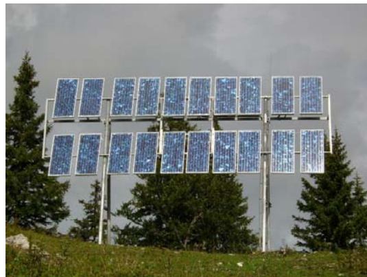
Die neue Photovoltaik-Anlage
